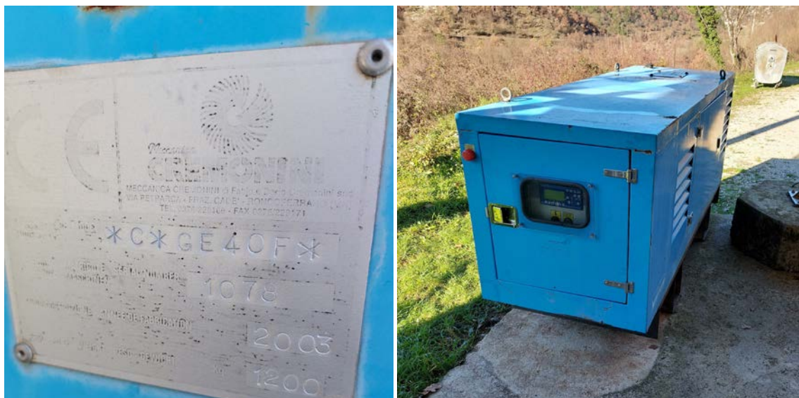
Slika 3: Izgled postojećeg dizel električnog agregata
