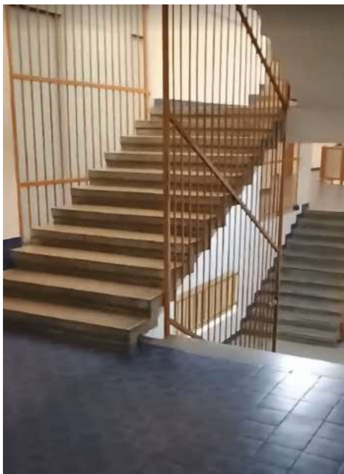
Sl.4: Stepenišni krak na prizemlju, mjesto parkiranja kose platforme.
