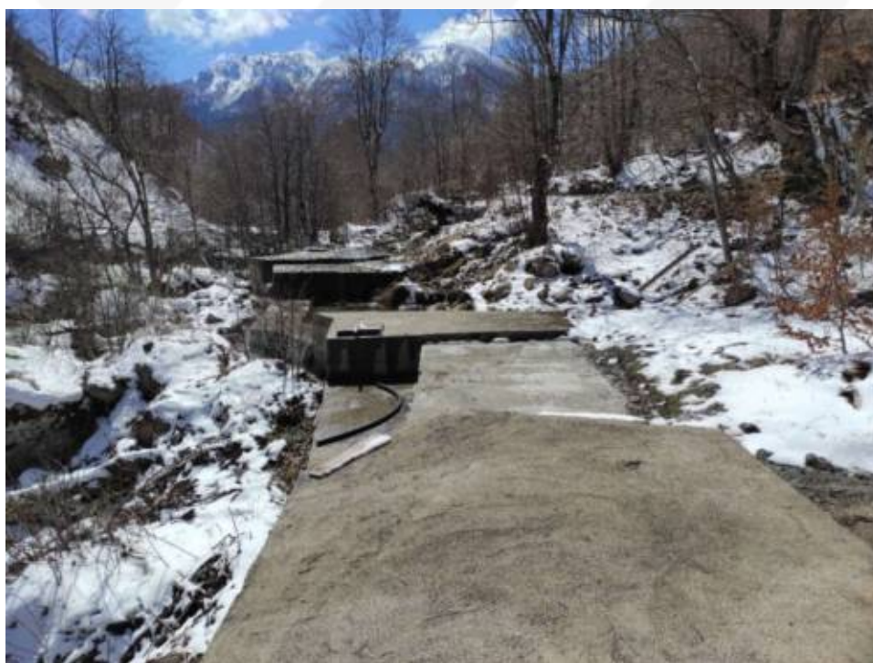
Slika 2.7.5 Kaptaze vodoizvorišta „Krkori“ sa dijelom sabirnog kanala
