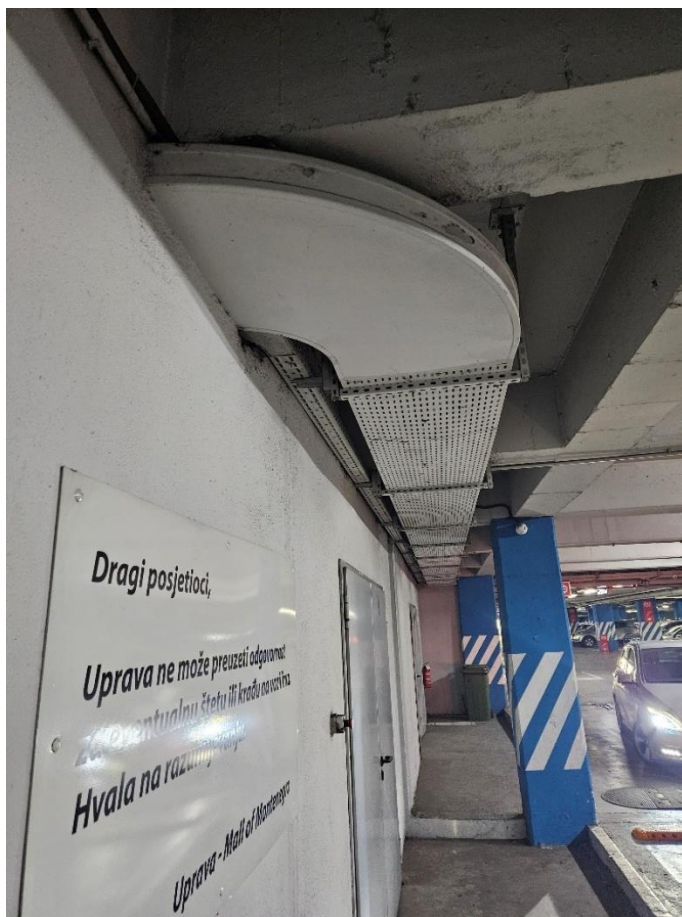
Slika br.1 Ulaz u NN blok priključne MBTS 10/0,4kV I postojeći regali za polaganje novih napojnih kablova
