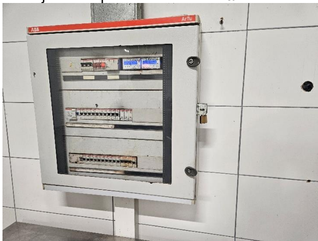
Slika br.5 Postojeća razvodna table ribarnice
