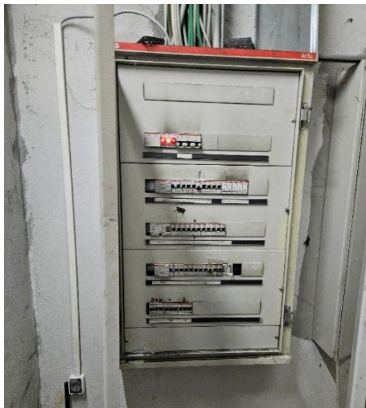
Slika br.4 Postojeća razvodna tabla u prostoru za prodaju mliječnih proizvoda
