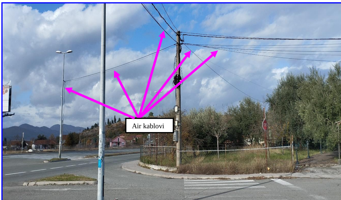
Slika 7: Air kablovi na stubovima rasvjete i betonskim stubovima distributivne energetske mreže. Slikano od P1n okna duž bulevara prema Podgorici.
