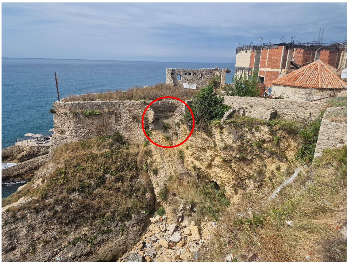
Slika 1: Dogođen odron, sa desne strane potencijalne dodatne nestabilnosti
