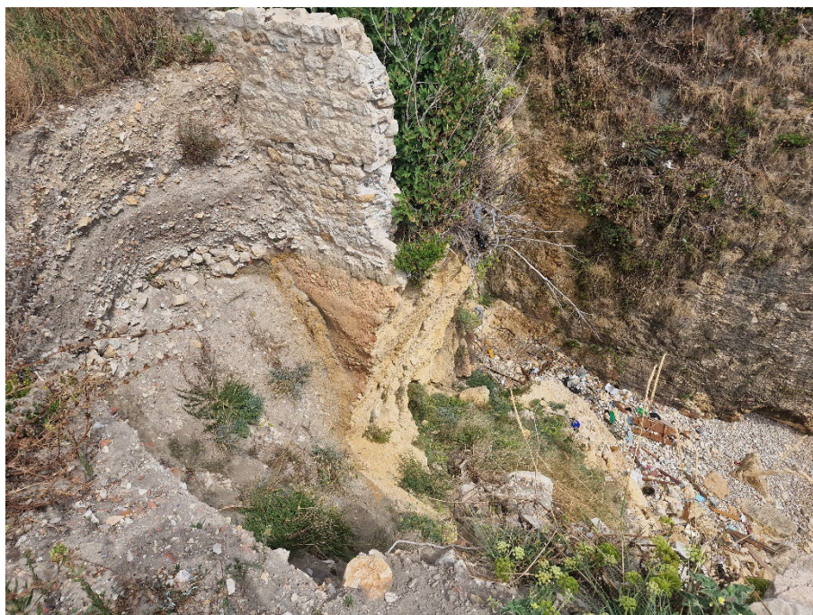
Slika 9: Dio kosine desno od dogođenog odrona sa nepovoljnim pukotinama i sa kontra nagibom
