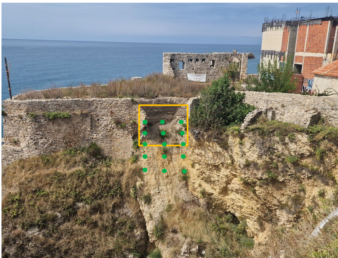
Slika 8: Predlog za način sanacije na dijelu dogođenog odrona
