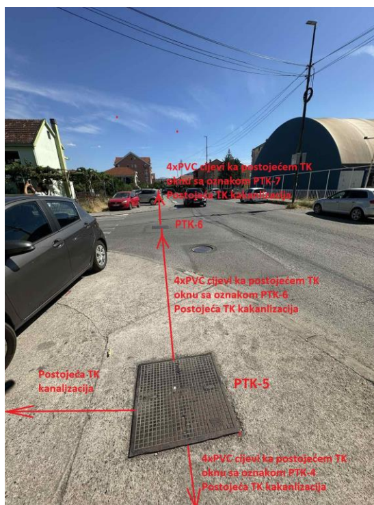
Slika 7: Postojeća okna PTK-5 i PTK-6 sa pripadajućom instalacijom
