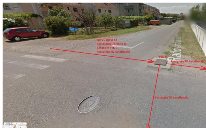
Slika 9: Postojeće okno PTK-9 sa pripadajućom instalacijom
