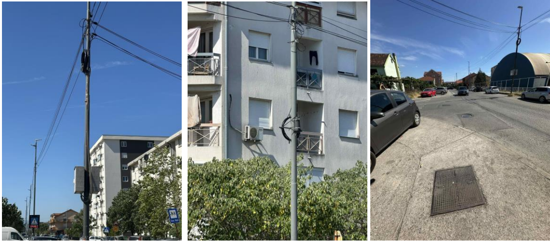
Slika 10: Postojeća vazдушna kablovska instalacija
