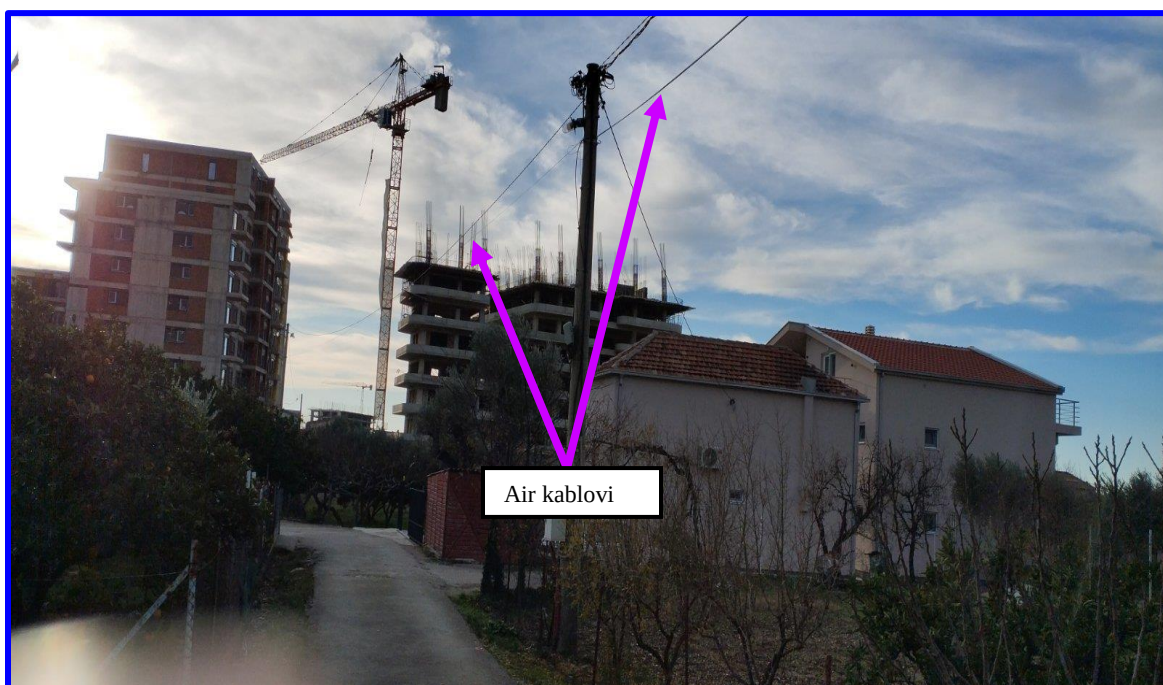
Slika 5: Betonski stub sa air kablom prije profila PR23. Slikano od profila PR24 u pravcu opadanja profila.
