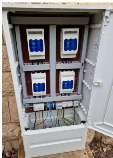
Elektro orman iz koga se obezbedjuje napajanje potrošača na okretnici
