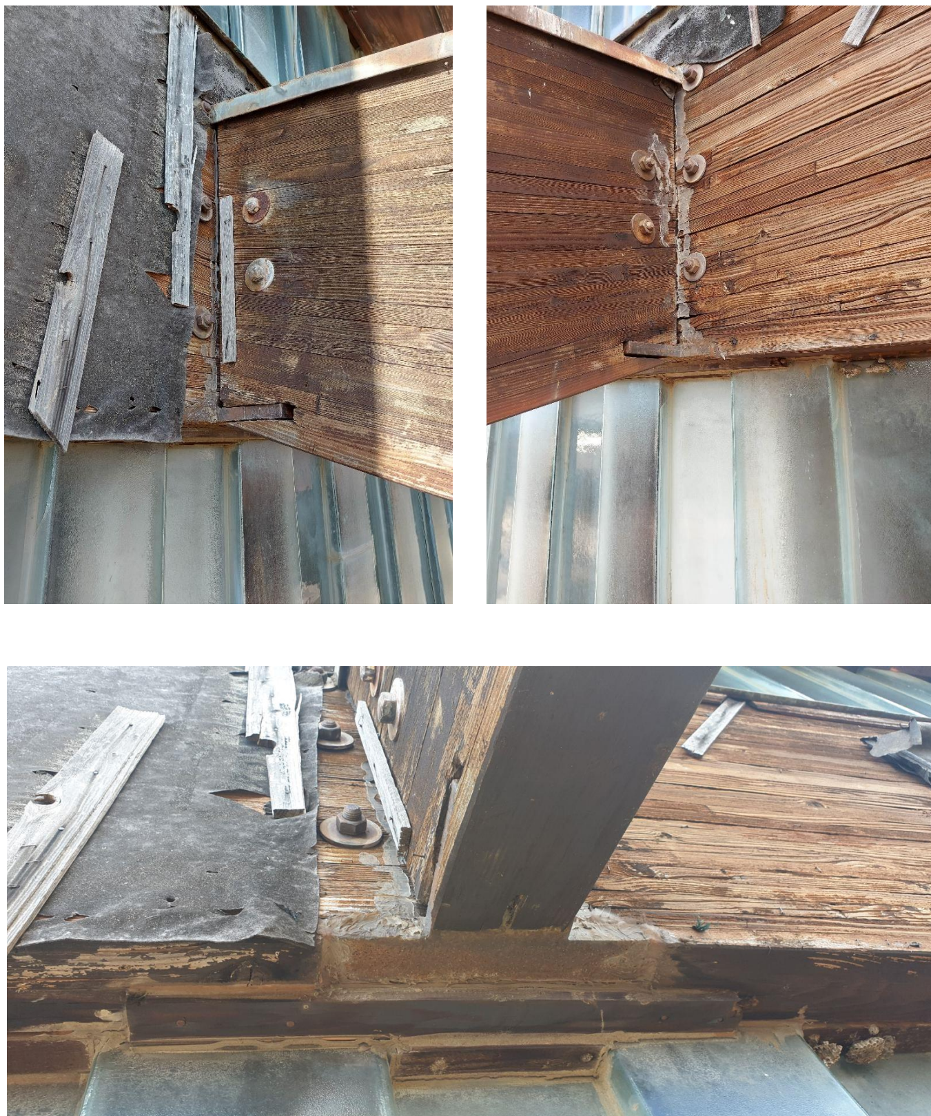
Slika 18. Detalji veze glavnog nosača male sale i zidne podvlake velike sale, sa brojnim oštećenja drveta i korozijom čeličnih elemenata veze
