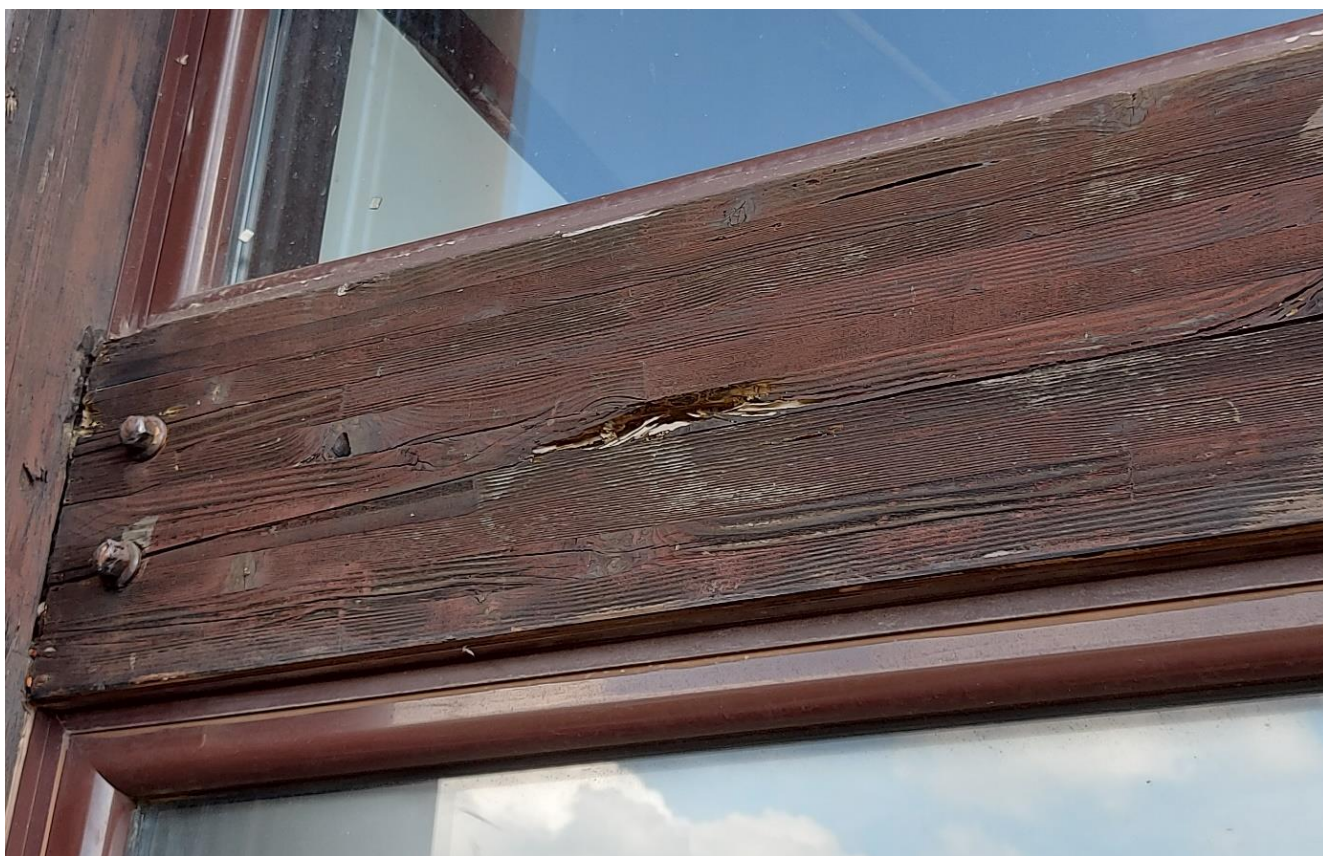
Slika 25-2. Oštećenja drveta fasadnih greda ulaznog hola
