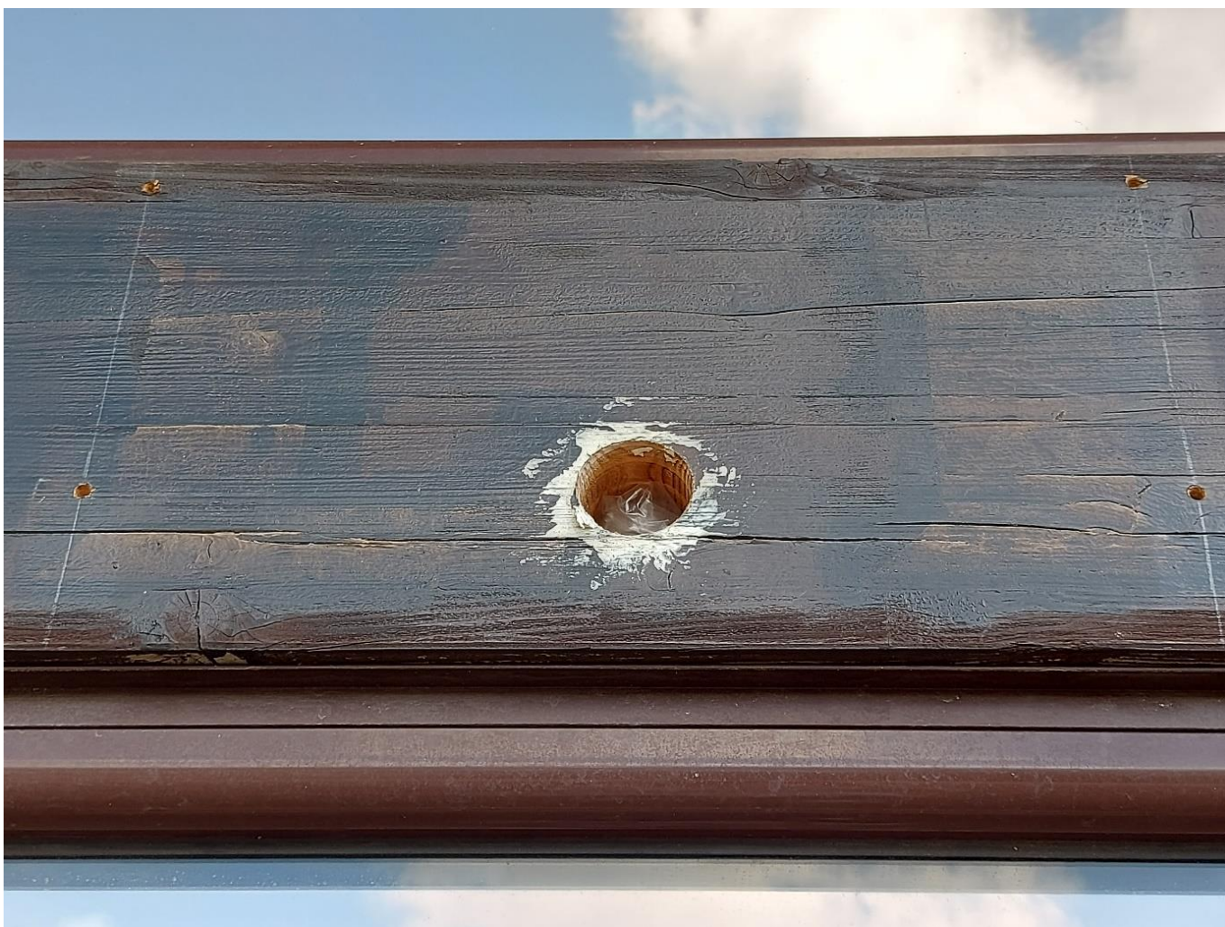
Slika 25-3. Oštećenja drveta fasadnih greda ulaznog hola
