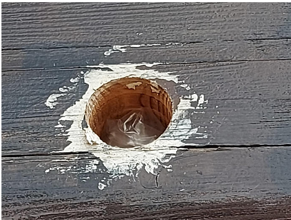
Slika 26. Rupe od instalacionih prodora u fasadnim gredama ulaznog hola
