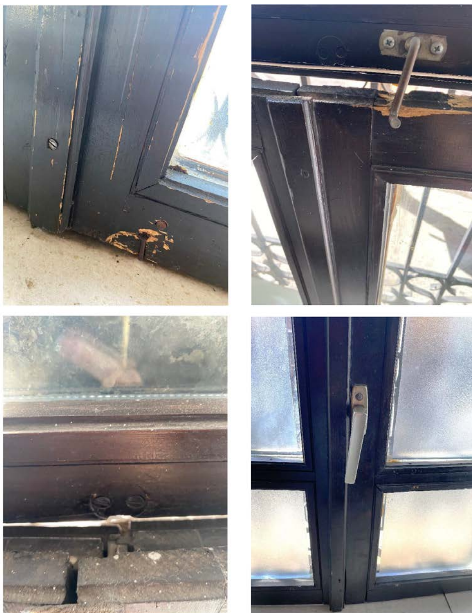
Prilozi 16-19. Prikazi oštećenja kod drvenih fasadnih otvora
