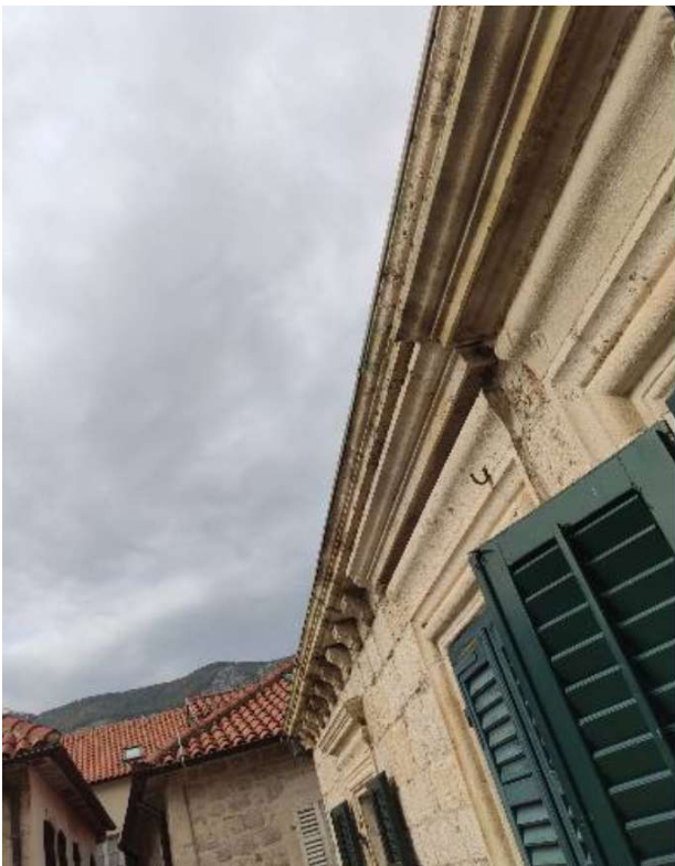
Dio fasade koji se sanira
