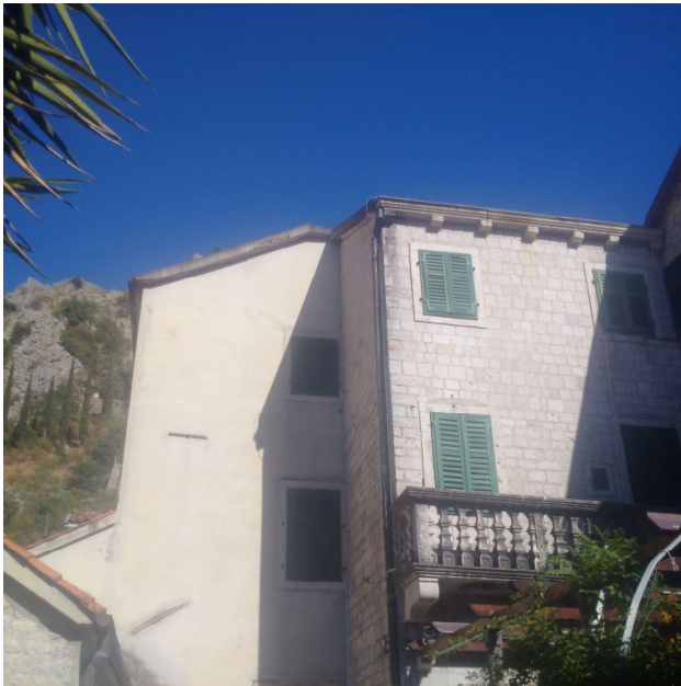
Dio fasade koji se sanira
