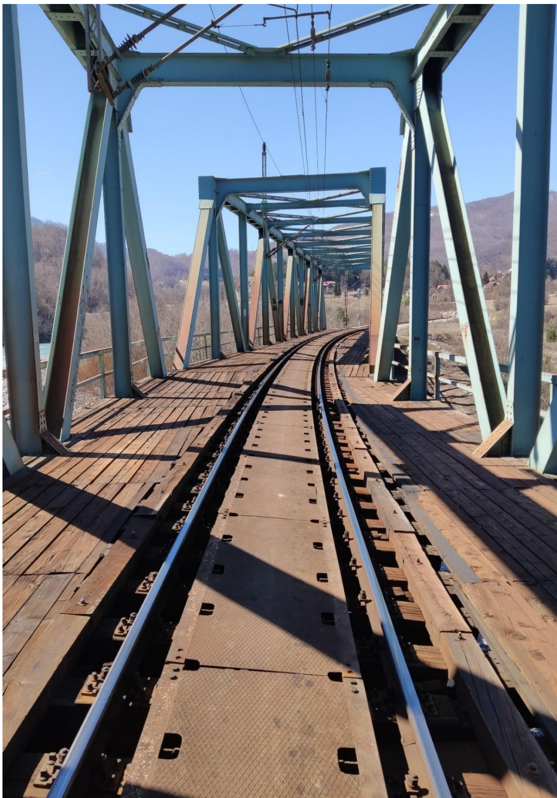
Kolosjek na mostu
